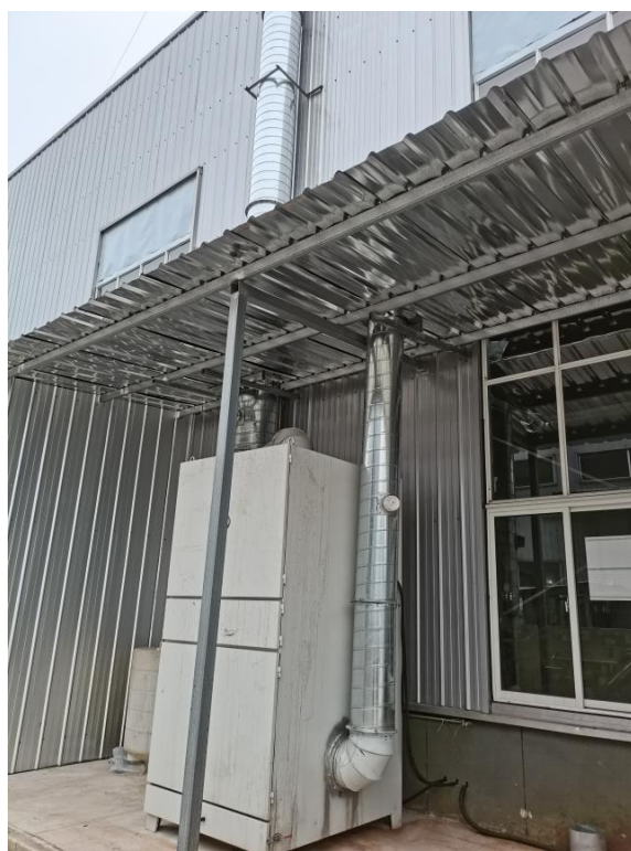
图 3-3 布袋除尘器及排气筒（DA001）
