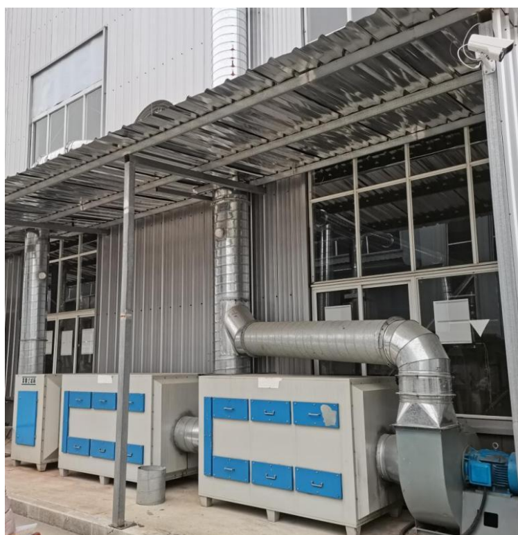
图 3-5 过滤箱、二级活性炭吸附装置及排气筒（DA002）
