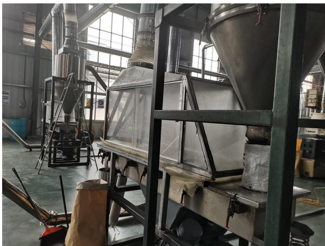
图 3-1 风冷切粒振动筛分过程废气收集措施
