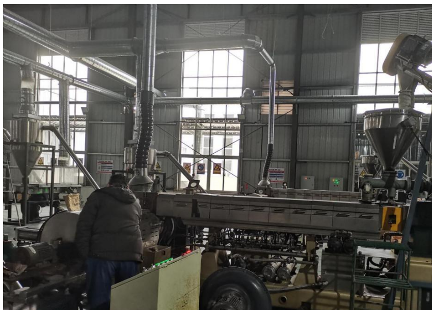
图 3-4 风冷切粒熔融、挤出、造粒过程废气收集装置
