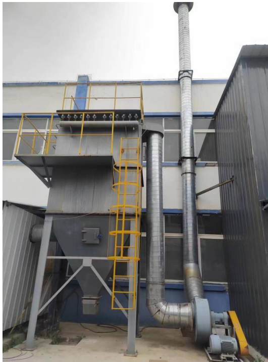
废气处理设施
