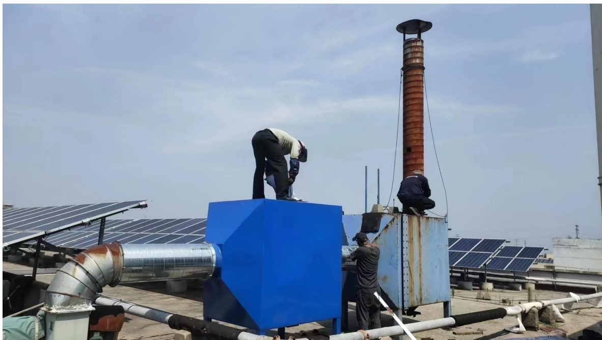
活性炭吸附装置+排气筒
